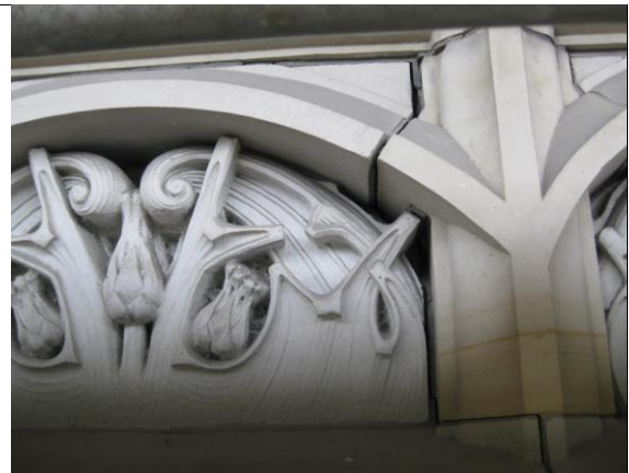
Bilde nr 13 Tydelige deformasjoner på sandsteinsomramning
