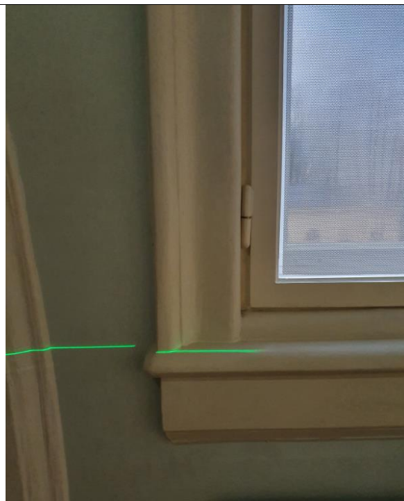
Bilde nr 6: Rom 332 Kontrollmåling av skjevstilling vindu med laser. Målt 28mm ut av vater
