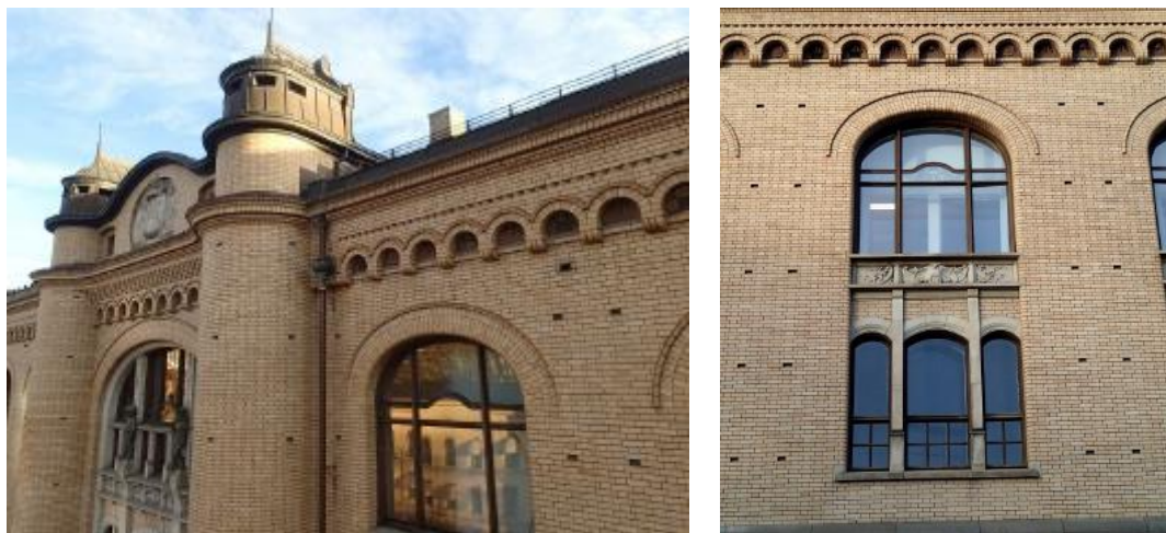
Bilde 4: Trykkbuer over vinduer i teglfasade
