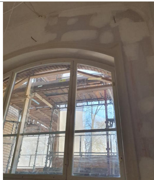
Bilde nr 9: Skade over vindu Rom 332
