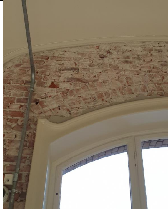
Bilde nr 8: Rom 114 Riss- sprekkdannelse i 1/3 punktet over vindu. Skade på trykkbue er tidligere utbedret.
