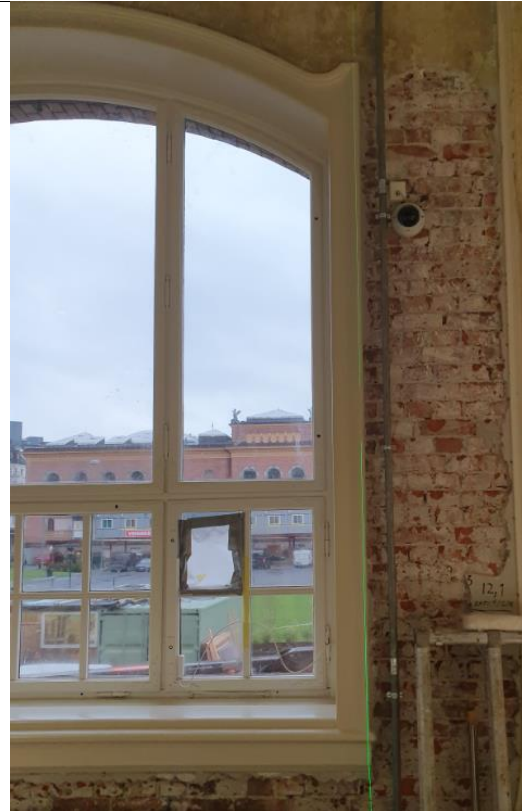
Bilde nr 7: Rom 114. Kontrollmålt skjevstilling vindu med laser Målt 12mm ut av lodd, 32mm ut av vater
