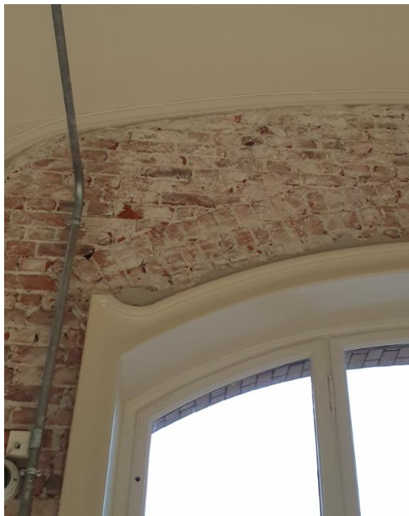
Bilde nr. 22: Rom 114 Tverrskip nord Riss- sprekkdannelse i 1/3 punktet over vindu. Skade på trykkbue er tidligere utbedret.
