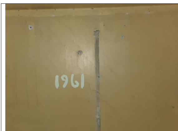
Bilde nr 26: Skråstilte riss i midtskipet
