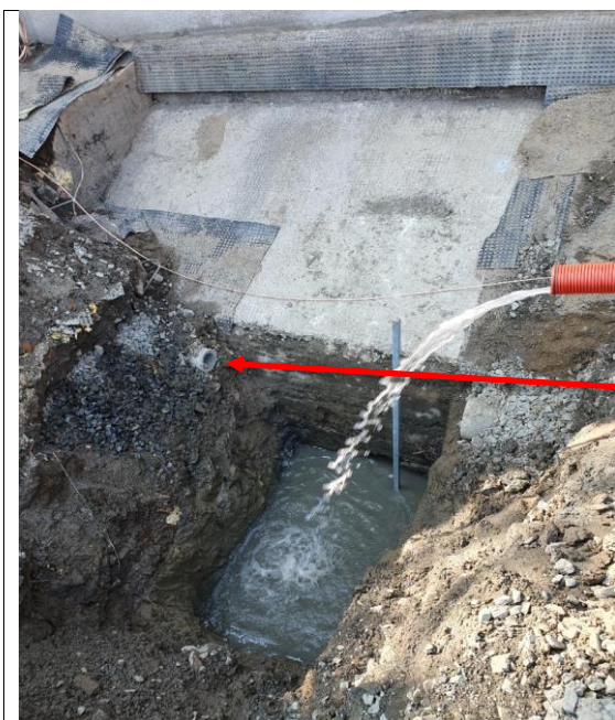
Bilde nr 1: Punktgraving 10.09.20 for kontroll av fundament og trepeler og høyde på grunnvannsnivå
