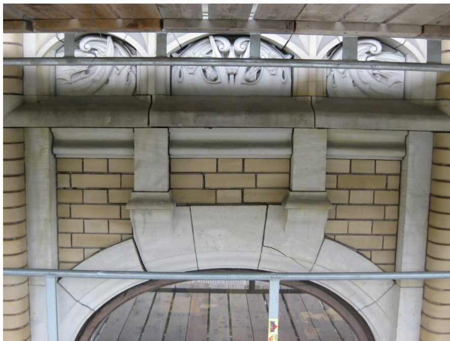
Bilde nr. 21: Oppsprekking i mørtelfuger og deformasjoner på sandsteinsomramning
