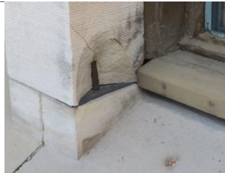
Bilde nr 11: Plassering av dybler som sammenføyer sandsteins blokker. Korrosjon på dybler har sprengt ut del av sandstein
