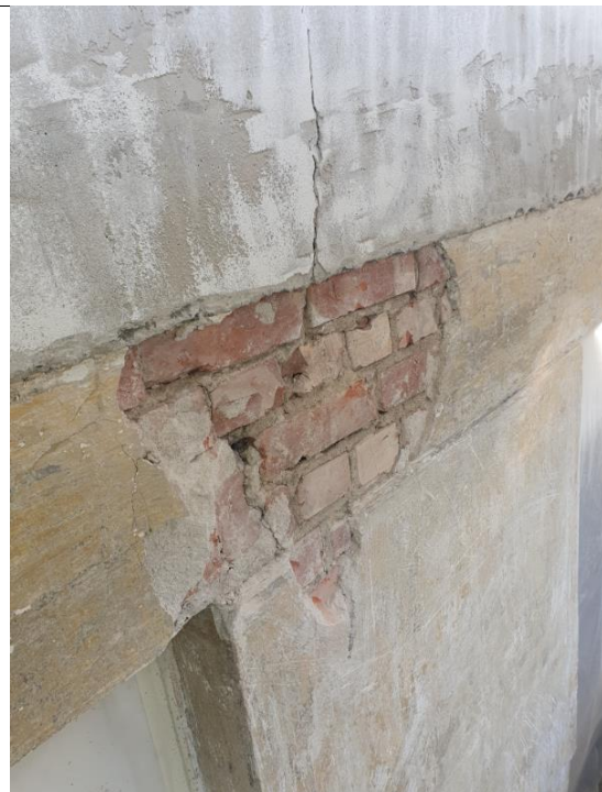
Bilde 10: Rom 115 Skade på søyle mellom vinduer grunnet setninger
