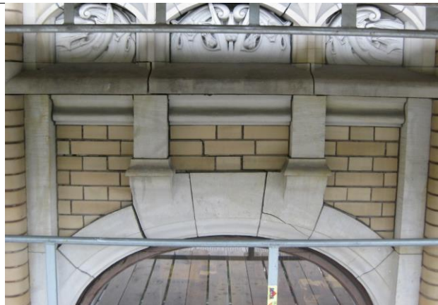
Bilde nr 12 Deformasjon på sandsteinsomramning. Sandstein belaster direkte vinduskonstruksjon.
