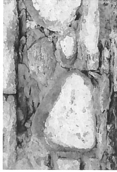
Jelling Kirke. Udsnit af gavltrekanstens vandrette granitbånd. Den karakteristiske frådrensbaserede mørtel er tydeligvis ikke fuget omkring stenene, men ligger som bløde ubehandlede vulster. – Fot: Sine Højbjerg.
