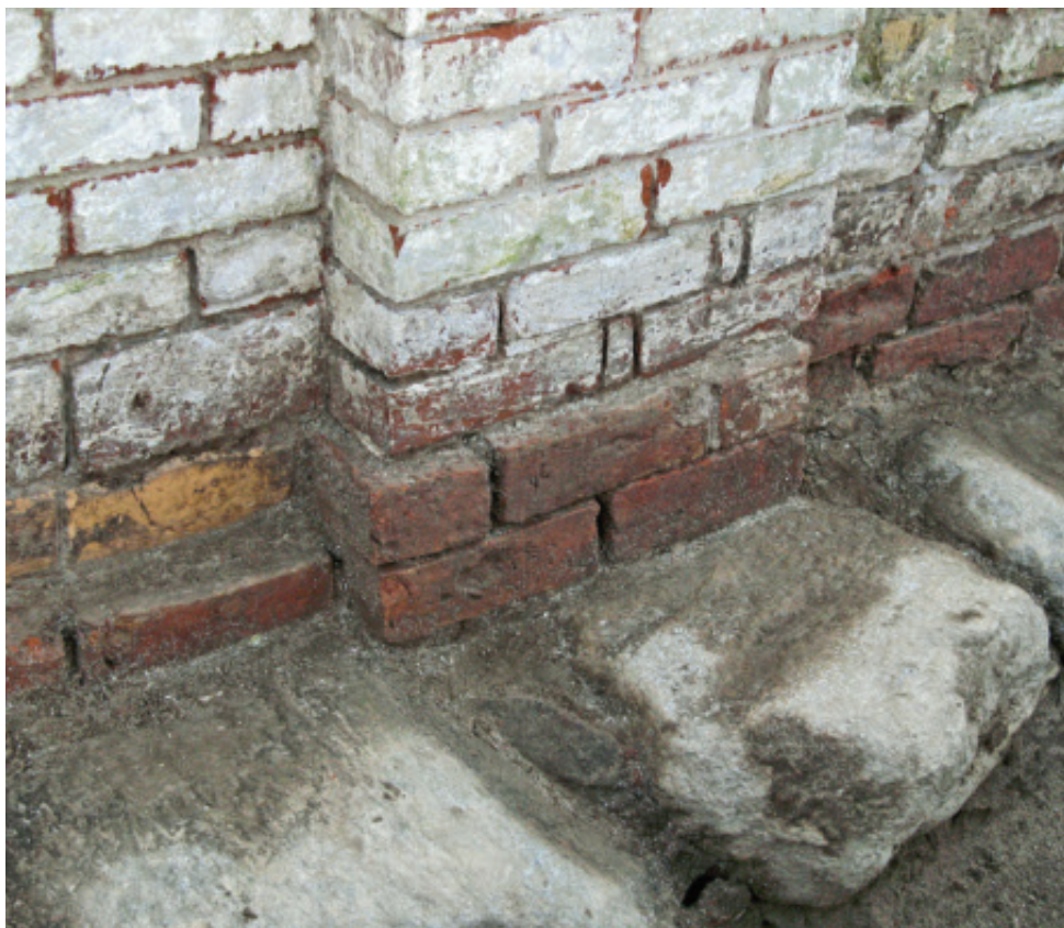
Fig. 11. Udsnit af den nordre kormurs blotlagte fundament. Den dårlige tilpasning af lisenen skyldes forskellen i stenformatet mellem kirkens 1. og 2. byggefase. Forskellene er på det viste murparti udlignet med tilhuggede teglsten. Foto: Thomas Bertelsen 2009.
